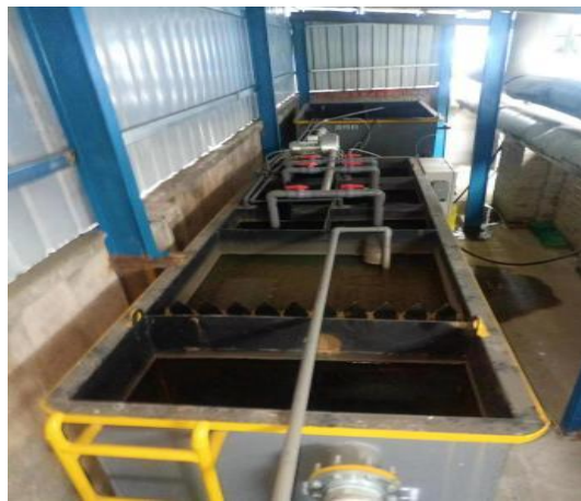
汽车零部件厂区污水处理站
