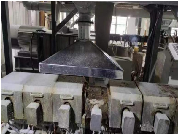
水环真空泵尾气集气罩
