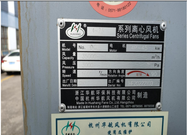
废气处理设施风机铭牌
